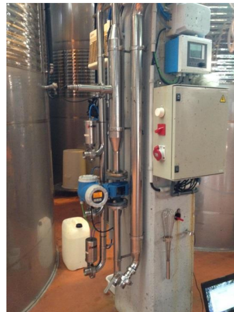
Medición de turbidez y caudal a la salida de la prensa / filtro tangencial
