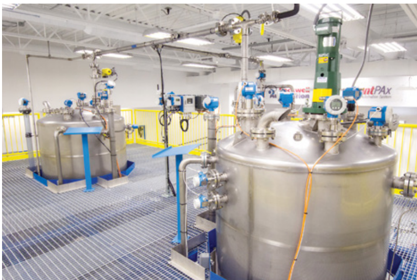
FIGURA 1. Reactores de Proceso con instrumentación inteligente
